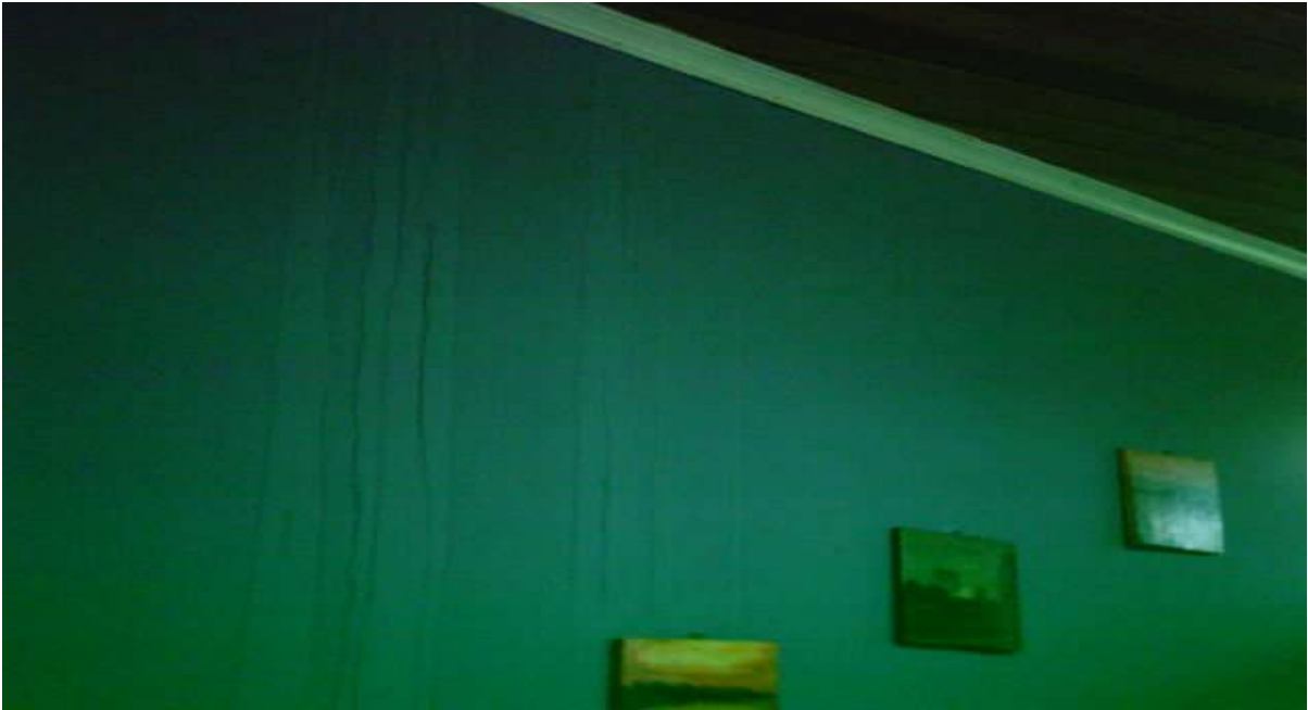
Figura 17 – Goteiras na parede do apartamento Autor: SOUSA, Stella. (2004)
