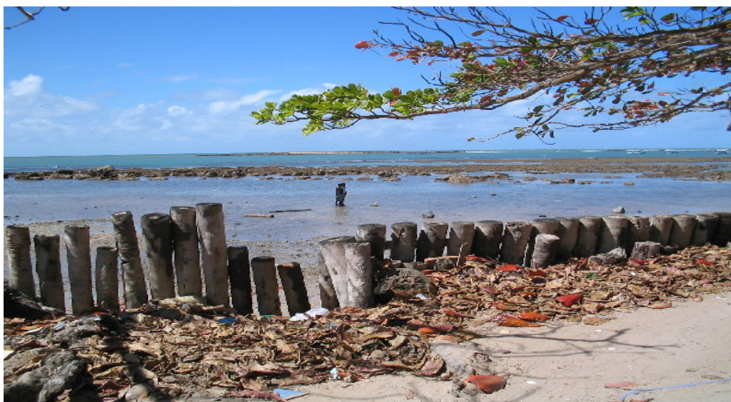
Fotografia 48: Antiga contenção para evitar erosão. Fonte: Azevêdo, 2004.
