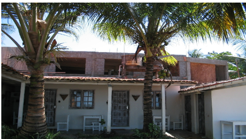
Fotografia 56: Construção embargada. Fonte: Azevêdo, 2005.
